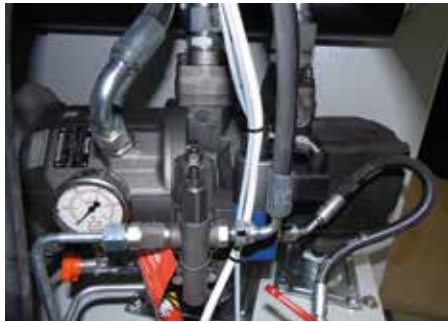
Unidade de controlo hidráulica
